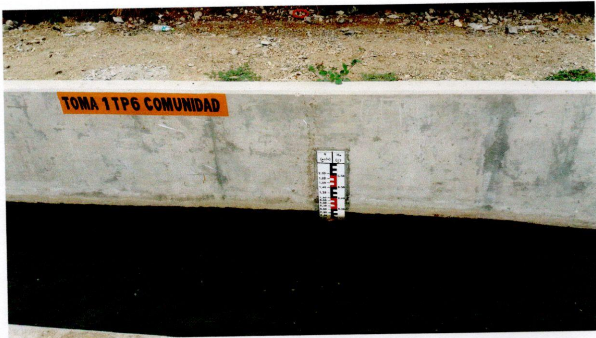
Medidor terminado TOMA 1 TP6 COMUNIDAD
