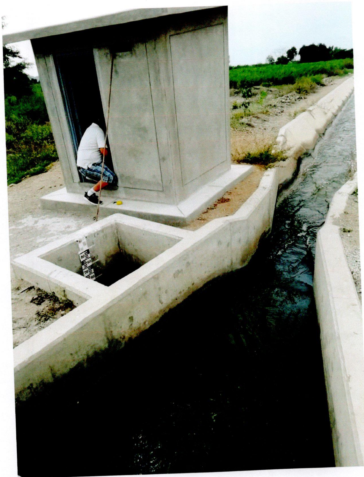
Caseta para la Instalación de los Limnigrafo
